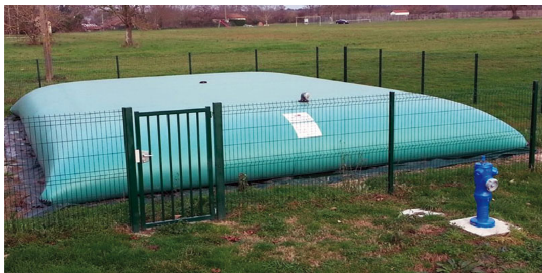
Exemple de citerne souple et point d'adduction
